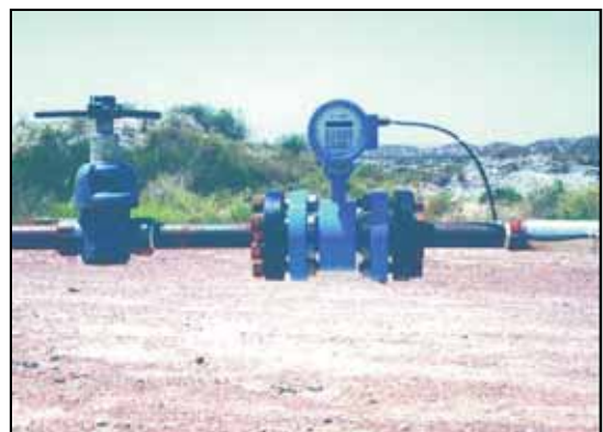
Equipo instalado en un yacimiento petrolífero en Tupungato, Pcia. De Mendoza
